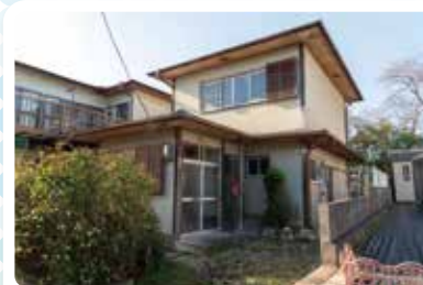
建物の老朽化が気になる
